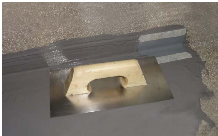
La BANDA IMPERMEABLE 120/70 se pegará al soporte con el mismo cemento cola o la impermeabilización o la pintura impermeable que estemos usando
